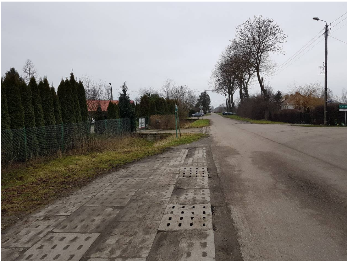
Zdjęcie nr 2: – km 0+027 L nawierzchnia istniejącej zatoki autobusowej
