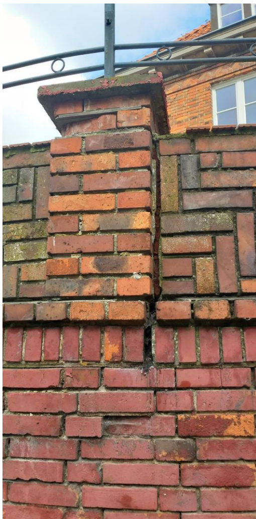
37. Widok pęknięcia balustrady w tarasie południowym hotelu Niemieckiej Wspólnoty Narodowej.
