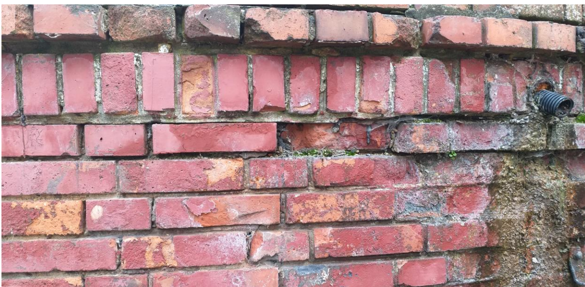
36. Korozja, ubytki i rozluźnienie wstęgu cegieł w tarasie południowym hotelu Niemieckiej Wspólnoty Narodowej.
