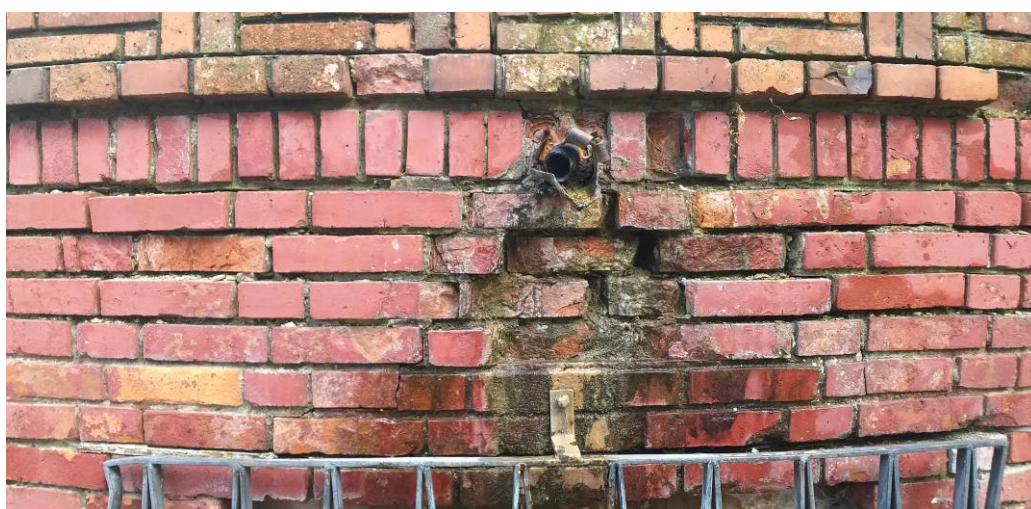
38. Zniszczenia cegieł w tarasie południowym hotelu Niemieckiej Wspólnoty Narodowej, spowodowane wyciekiem wody.
