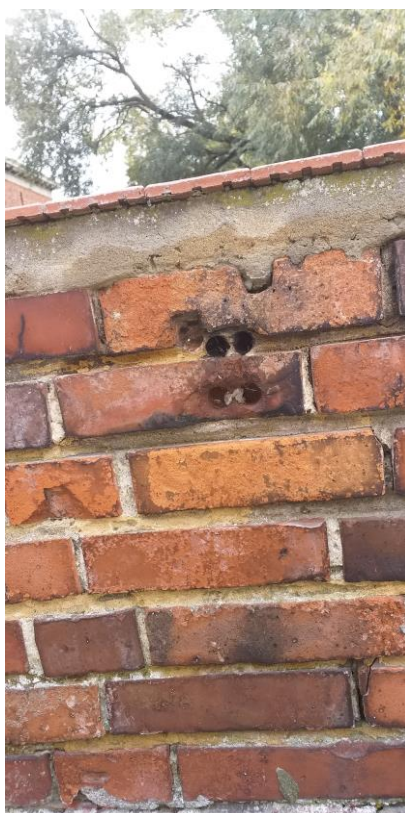
30. Widok otworów w wewnętrznej stronie balustrady tarasu południowego hotelu Niemieckiej Wspólnoty Narodowej.
