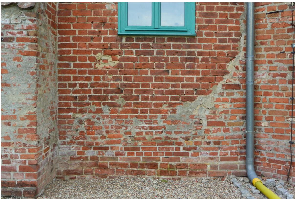
Kościół p.w. Św. Mikołaja w Żelichowie, ściana południowa – stan przed pracami konserwatorskimi
