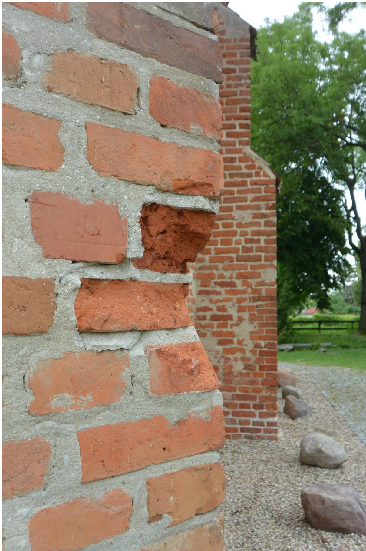
Kościół p.w. Św. Mikołaja w Żelichowie, ściana południowa – stan przed pracami konserwatorskimi
